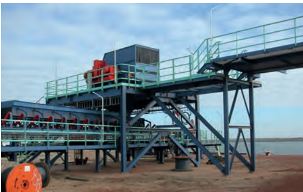
Bandantriebsstation im Tagebau / Conveyor drive station in open cast mining
