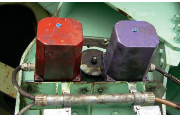
Vorher: Mechanische Spindelendschalter / Before: Mechanical spindle limit switches
