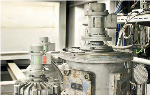
Vorher: Analoge Tachogeneratoren / Before: Analog tachogenerators
