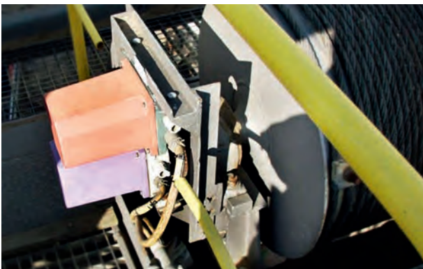
Vorher: Mechanische Endscharter / Before: Mechanical cam limit switches
