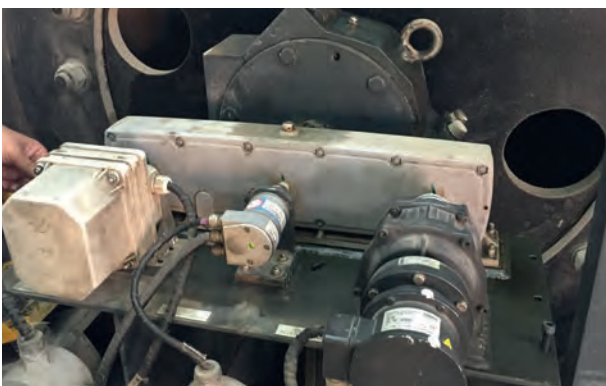
Vorher: Verteilergetriebe mit mechanischem Kopierwerk, Absolutwert-Drehgeber und mechanischem Fliehkraftschalter / Before: Distribution gear with mechanical cam limit switch, absolute encoder and mechanical overspeed switch
